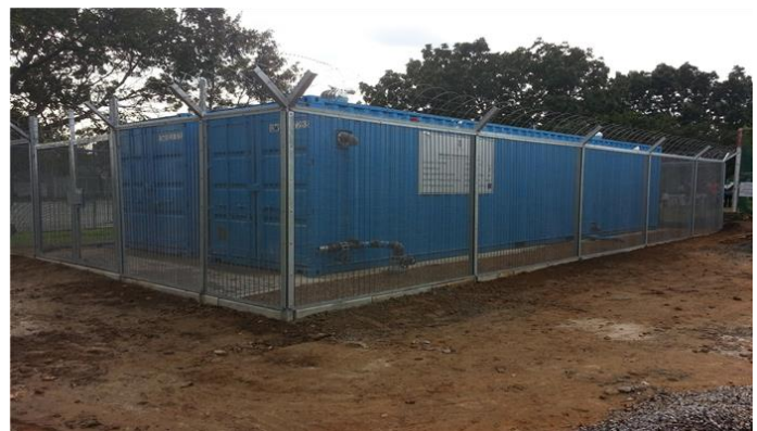
Figure 41: Stellenbosch Containerised WTW – Van der Stel
